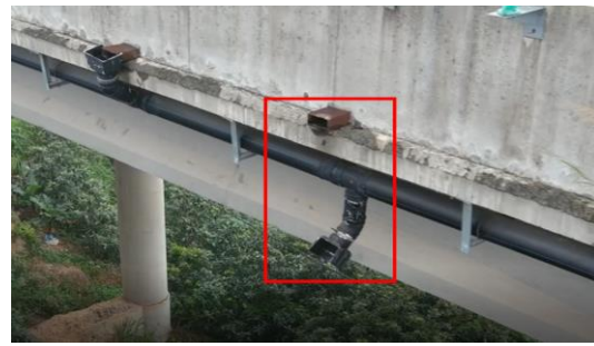
图 3-25: 雨水斗侧向脱落
