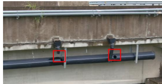
图 3-27: 竖向排水管与纵向排水管连接处脱节
