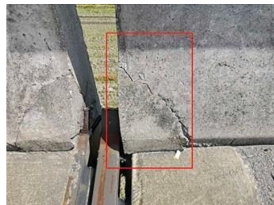
图 3-22 黄石高架桥右幅 HL-R-1 右侧护栏: 距 98 号墩顶 0m 处, 右侧剥落; 数量: 1 处, 长度: 0.003m, 宽度: 0.002m。
