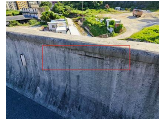
图 3-23: 江口高架桥左幅 HL-L-1 左侧护栏: 距 49 号墩顶 0m 处露筋; 数量: 1 处, 长度: 0.5m, 宽度: 0m。
