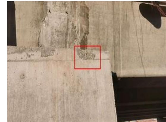
图 3-15: 江口高架桥左幅 GL-13D 盖梁: 左侧挡块剥落; 数量: 1 处, 长度: 0.2m, 宽度: 0.2m。
