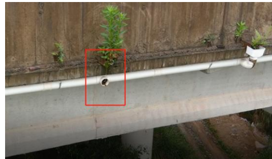
图 3-33: 缺失雨水斗, 竖向排水管
