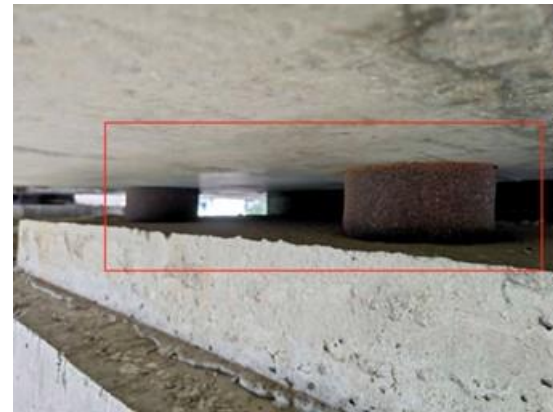
图 3-18: 黄石高架桥右幅 ZZ-134-133-3 支座: 大桩号面临时支座未拆除; 数量: 2 个, 最大长度: 0.1m, 最大宽度: 0.1m。
