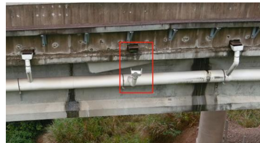
图 3-32: 雨水斗侧向脱落
