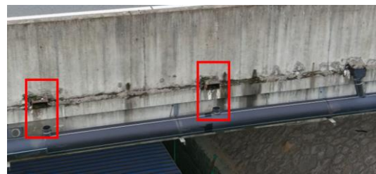
图 3-29: 缺失雨水斗, 竖向排水管及纵向排水管
