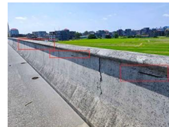
图 3-21 黄石高架桥左幅 HL-L-1 左侧护栏: 距 36 号墩顶 10m 处露筋; 数量: 3 处, 最大长度: 0.01m, 最大宽度: 0m。
