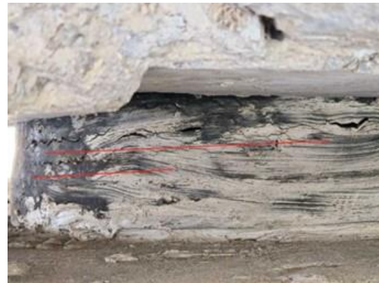
图 3-19: 江口高架桥左幅 ZZ-45-45-9 支座: 大桩号面横向开裂; 数量: 2 条, 最大长度: 0.3m, 最大宽度: 0.13mm。
