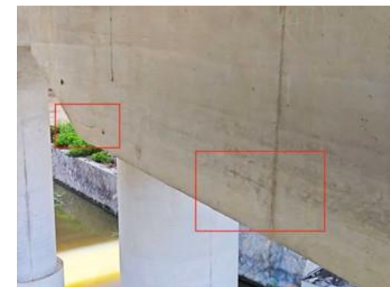
图 3-13: 黄石高架桥左幅 GL-48D 盖梁: 距右侧 0m 起, 距下缘 0.3m 起, 大桩号面露筋; 数量: 3 处, 最大长度: 1m, 最大宽度: 0m。
