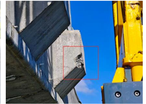
图 3-24: 江口高架桥右幅 HL-R-1 右侧护栏: 距 21 号墩顶 0m 处剥落; 数量: 1 处, 长度: 0.3m, 宽度: 0.3m。
