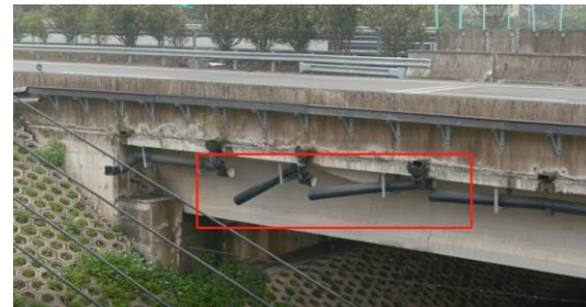
图 3-28: 相邻纵向排水管连接处错位、脱节
