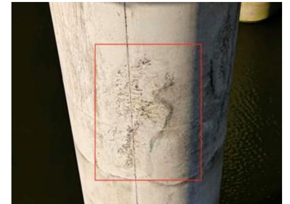
图 3-16: 江口高架桥右幅 DS-9-1D 墩身: 距上缘 2m 处, 墩身蜂窝、麻面; 数量: 1 处, 长度: 2m, 宽度: 1m。
